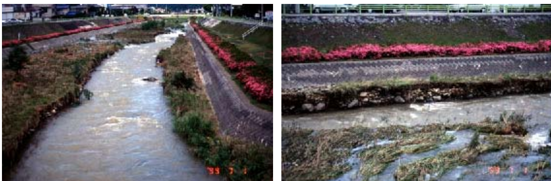
図1 1999年6月の大雨のあと出現した深掘れ地形．まっすぐで箱形の深い谷地形が特徴（左） 護岸コンクリートの足もとがけずられると，堤防が壊れる危険性がある（右）
